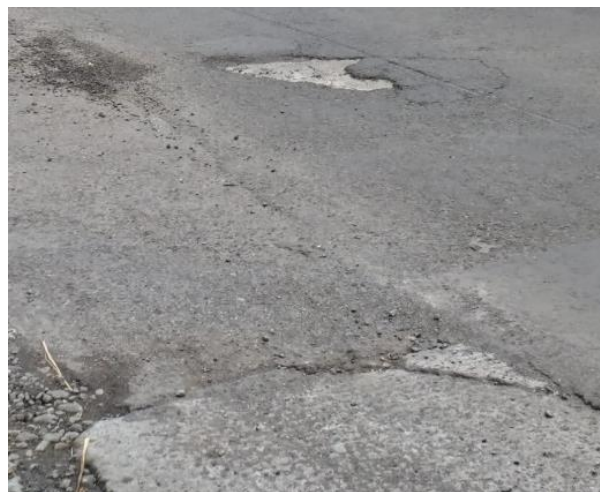
Gambar 1. 4 Gambar 1.4 Kerusakan Jalan Pada Jalan Raya Kediri – Nganjuk (Sumber : Dokumentasi pribadi)
