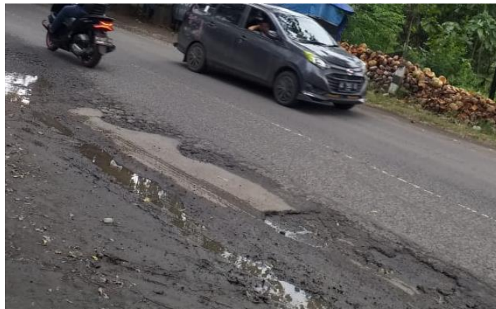
Gambar 1. 3 Kerusakan Jalan Pada Jalan Raya Kediri – Nganjuk (Sumber : Dokumentasi pribadi)
