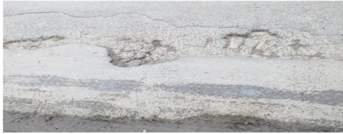
Gambar 1. 2 Kerusakan pada jalan Raya Kediri – Nganjuk (Sumber : Dokumentasi pribadi)
