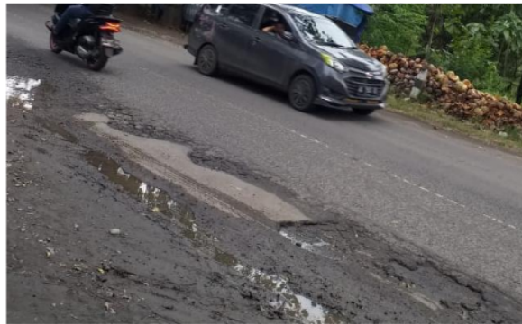
Gambar 1. 3 Kerusakan Jalan Pada Jalan Raya Kediri – Nganjuk (Sumber : Dokumentasi pribadi)
