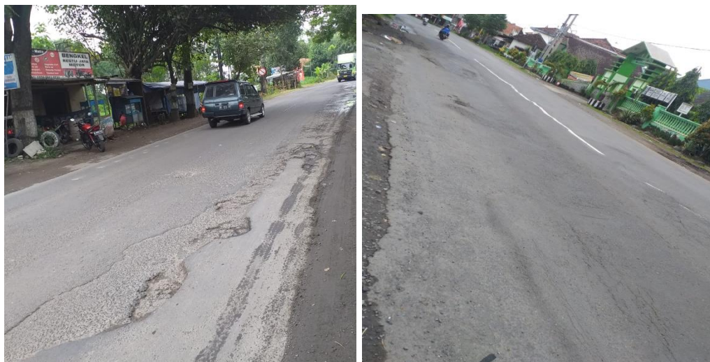
Dokumentasi Kerusakan Pada Jalan Raya Kediri – Nganjuk
