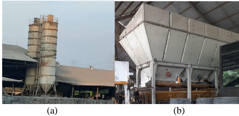
Gambar 3. 9 (a) Batcher Plant , dan (b) Silo Semen
