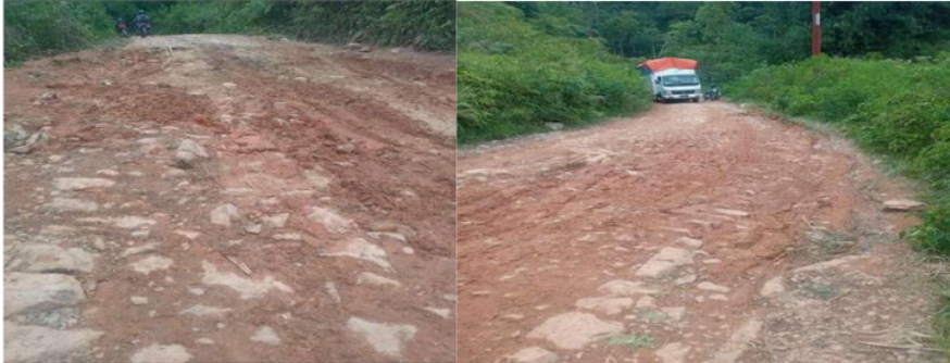
Gambar 1.1 Kondisi Jalan Dangka Mangka – Watunggong
